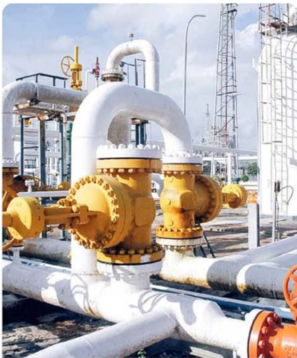
Centrum dystrybucji gazu.
